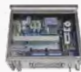
Coffret de pilotage
